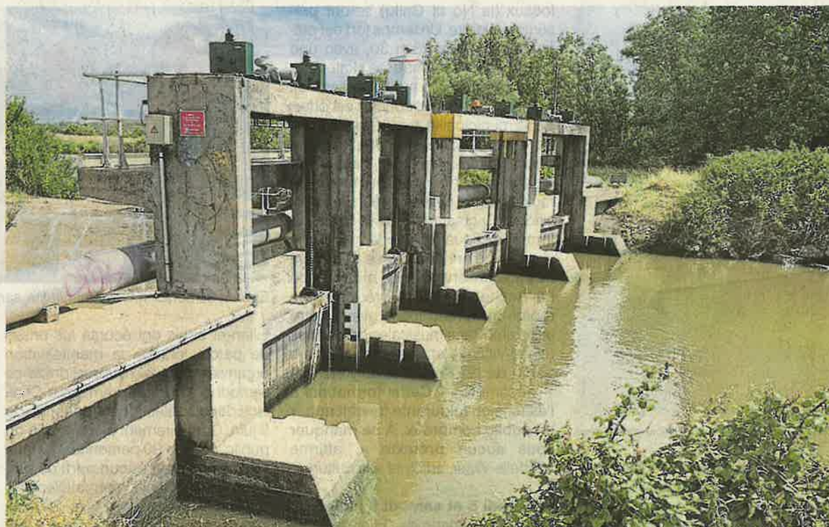
Les écluses de Riez, construites en 1938, vont être automatisées. Jusqu'à présent, l'éclusier devait s'y rendre pour gérer les niveaux d'eau.
