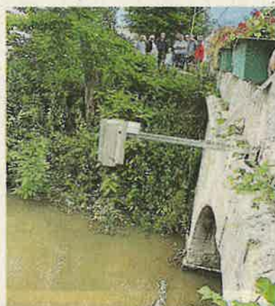
Une sonde posée en aval des écluses de Riez, à Notre-Dame-de-Riez. Elle permet de commander les barrages, en fonction du niveau d'eau.
