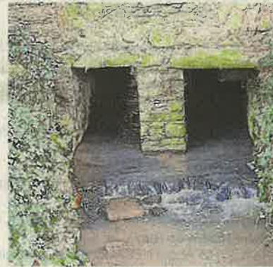
Le Pas du chien canalise le ruisseau la Grève et permet à l'eau de s'écouler sous la chaussée de la rue Joubert-de-la-Cour.
