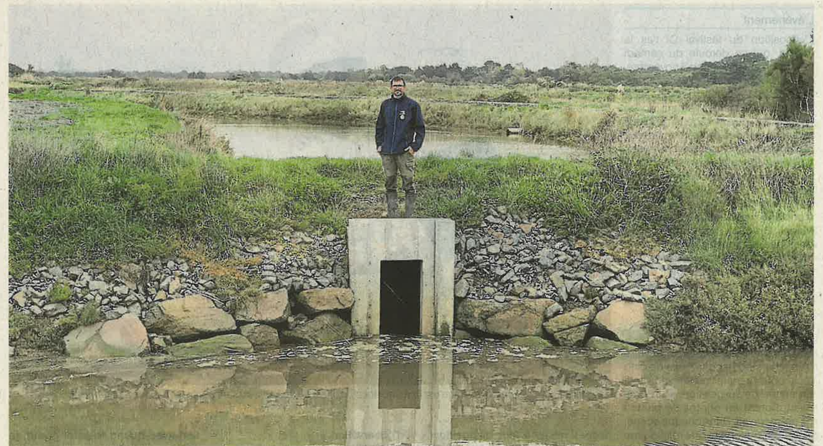
Une prise d'eau en cadre béton d'1,50 m de hauteur et toujours ouverte a été aménagée dans un marais public de Saint-Hilaire-de-Riez pour aider l'anguille à venir et repartir selon son stade de développement.
